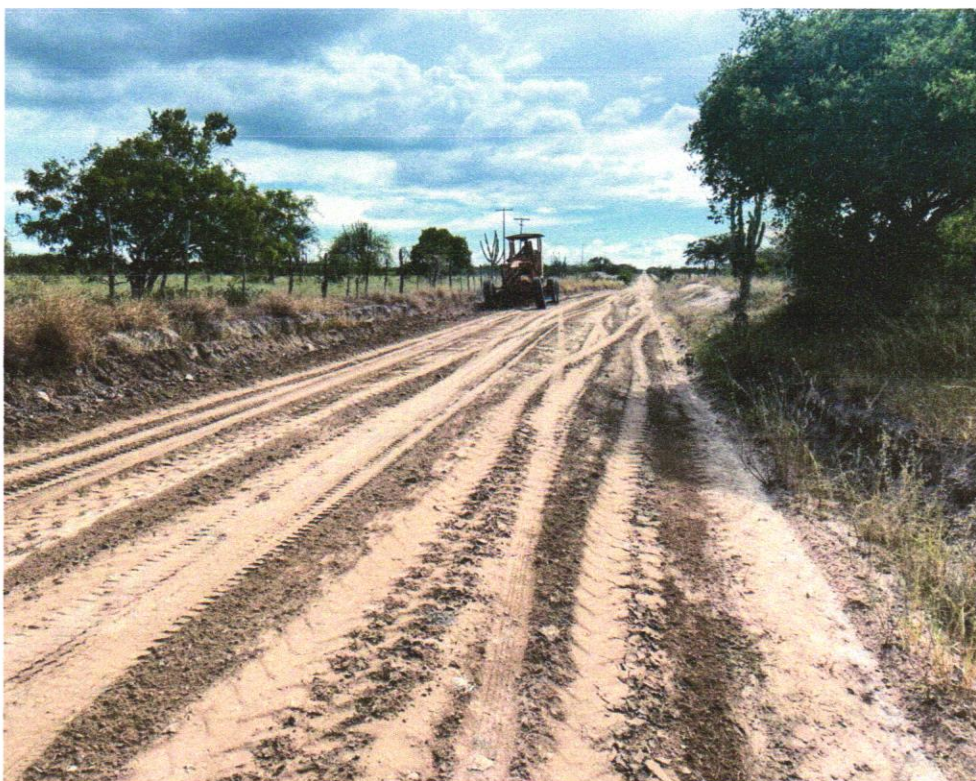
FOTO 03 - ESCAVACAO E CARGA MATERIAL 1A CATEGORIA, UTILIZANDO TRATOR DE ESTEIRAS DE 110 A 160HP COM LAMINA, PESO OPERACIONAL * 13T E PA CARREGADEIRA COM 170 HP
